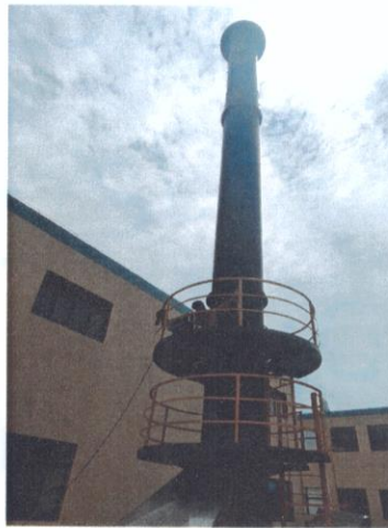
锅炉排气筒出口 01#
