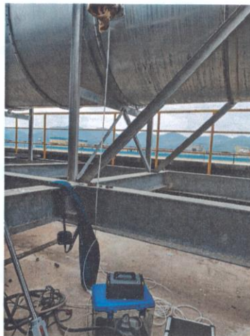
研究室排气筒出口 04#
